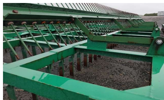
均し爪も多少の劣化、腐食があります。
