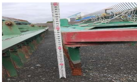
爪の長さは20cm程度・多少の劣化、腐食があります。
